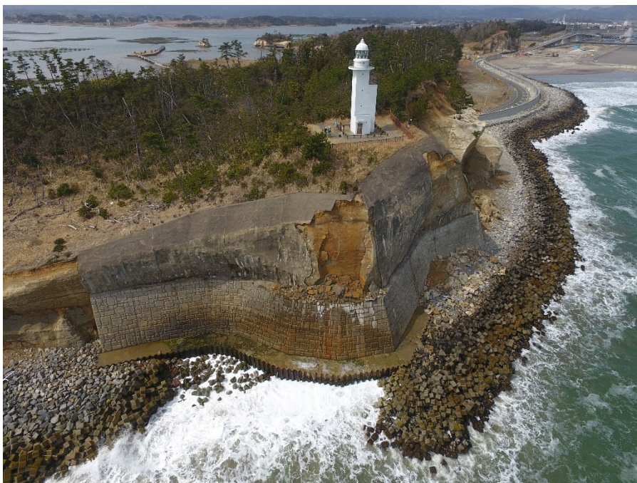
崩壊した法面
