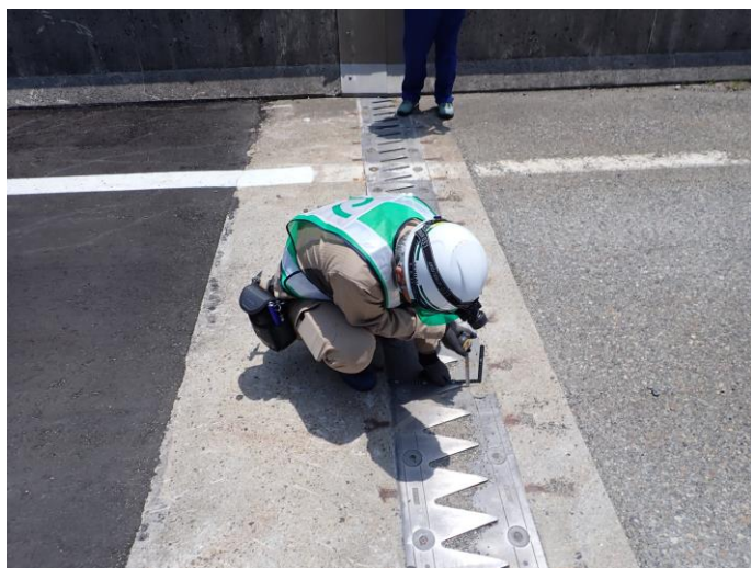
被災地における損傷した橋梁の調査(長大)
