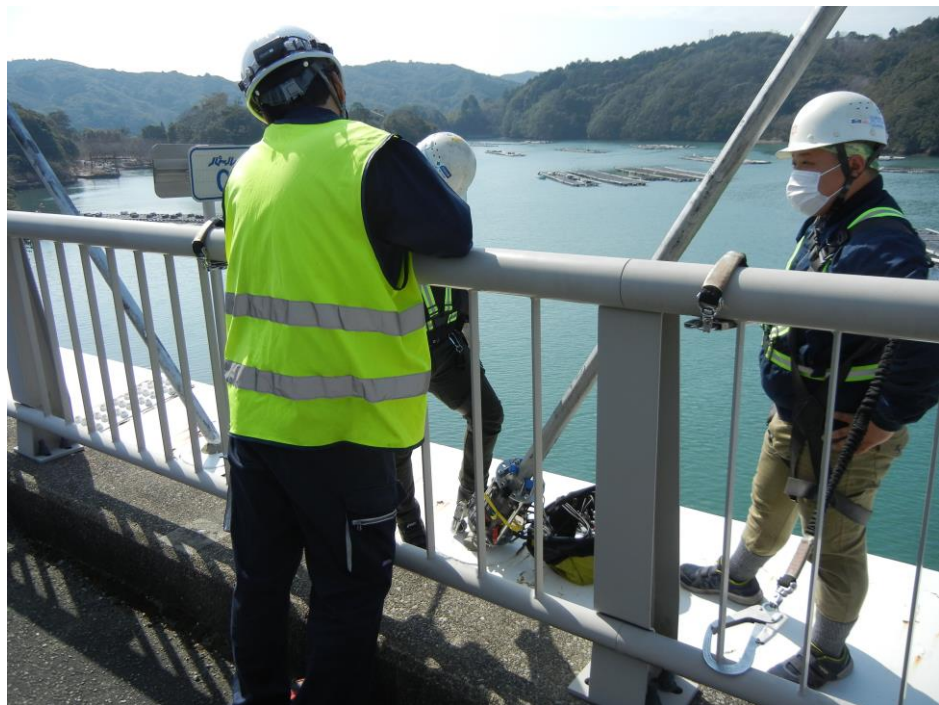
腐食、損傷した橋梁の詳細な調査を行った
