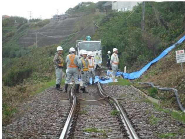
大雨による地すべりで被災した線路を調査(基礎地盤コンサルタンツ)
