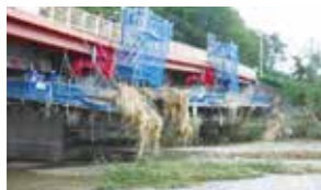
大善寺橋の被災状況
