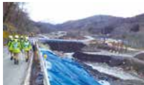
鳴岩橋の被災状況
