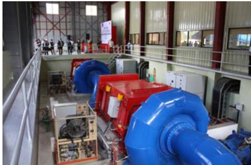
アシガ川小水力発電所（水車）
