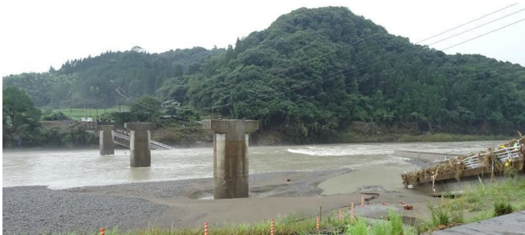
流出した橋梁
