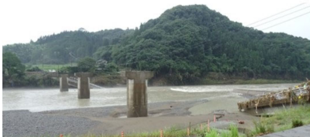
流出した橋梁
